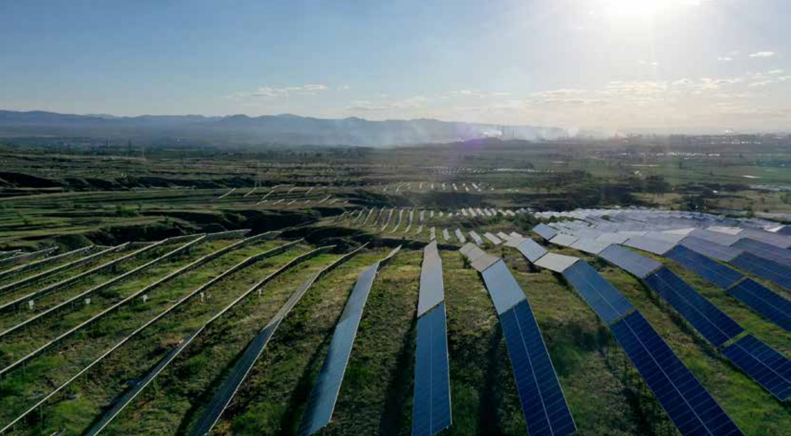
● 张家口宣化区光伏发电厂
